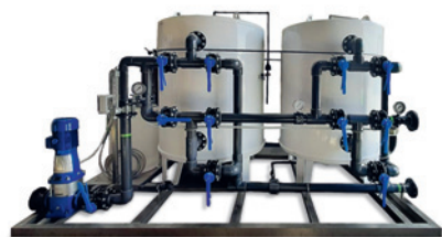
Impianti di trattamento acque "In-skid"
